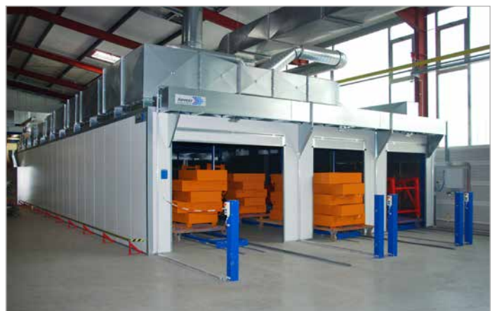
Lackiererei mit Trocknungsstraße
